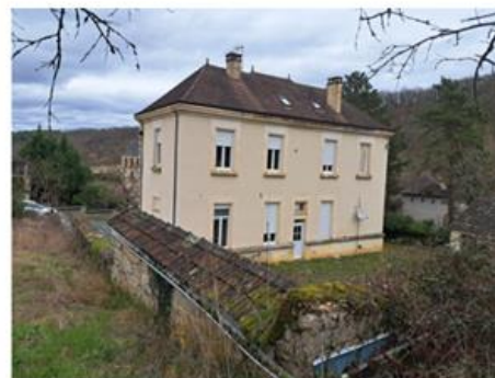
Façade Sud à reprendre
